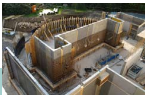
Platz für den Technikraum wurde neben und hinter dem halbkreisförmigen Becken geschaffen.
